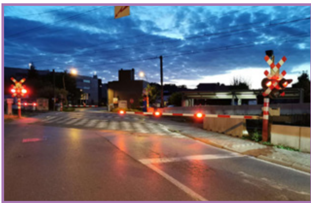
Figuur 30: Slagbomen met LED-verlichting. Bron: (Infrabel, 2024d)
