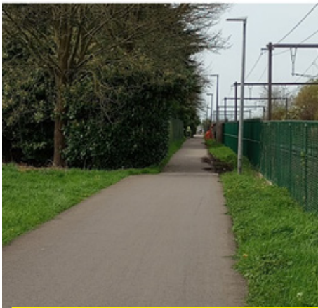
Aufgrund einer Verengung des Radschnellweges weicht der Zweiwege-Kran auf die sumpfige Böschung aus, wobei er dann ins Gleis abrutscht.
