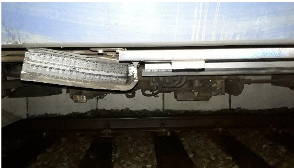
Door de bestuurder van trein E2189 genomen foto waarop de afwezigheid van de hulpkoppeling-koffer en de verbogen schuifrail te zien zijn (bron: NMBS).
